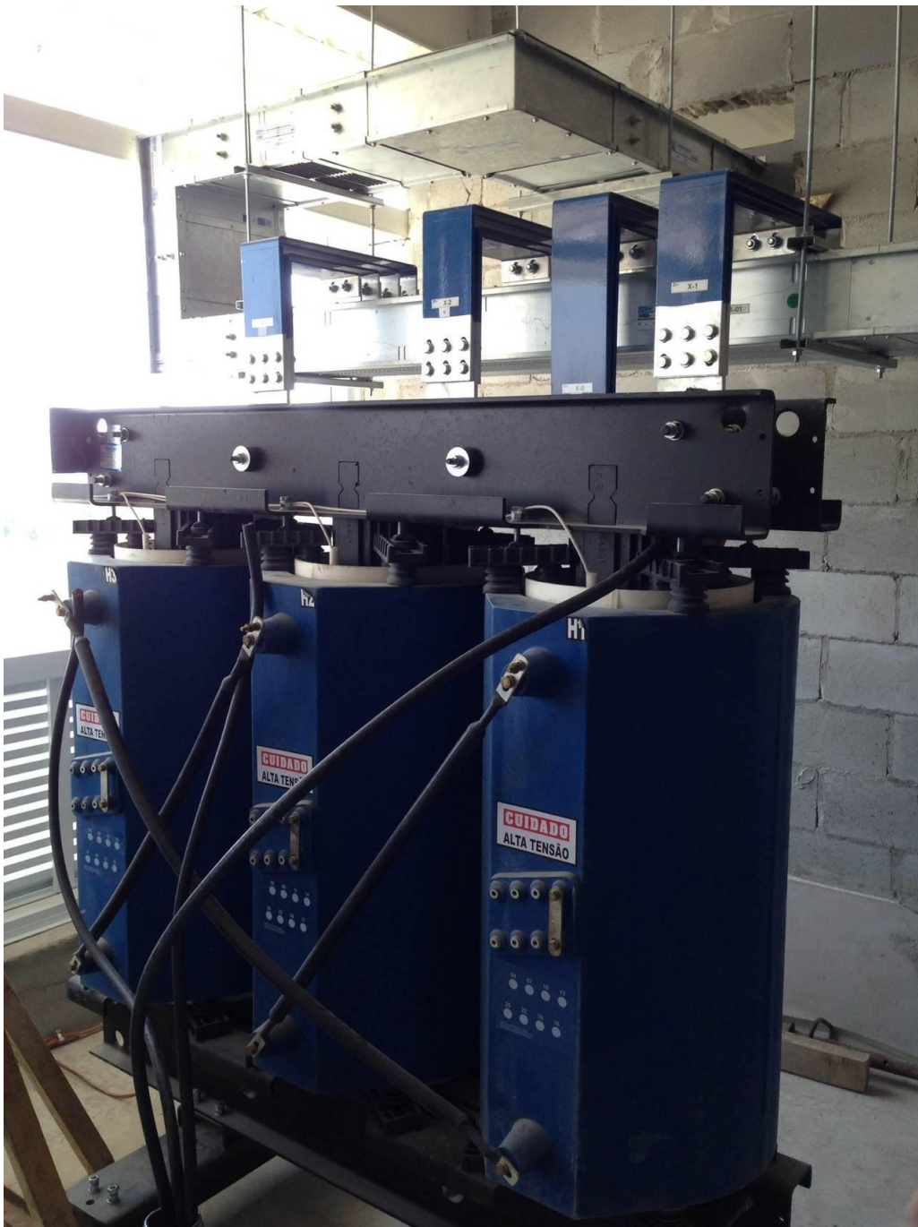
Imagem 23 – Transformador e ligação ao barramento blindado
