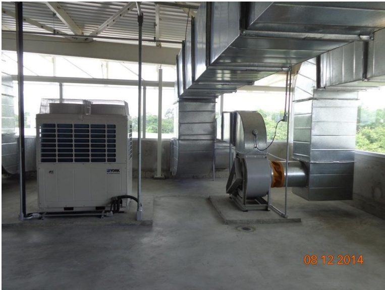
Imagem 19 – casa de máquinas do ar condicionado
