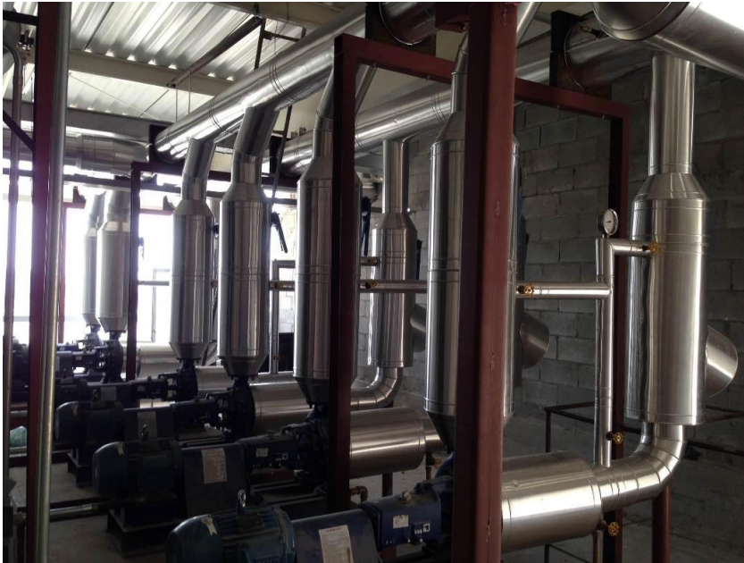
Imagem 18 – central de água gelada
